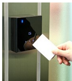
入退室管理システム
